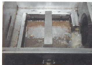
Arrivée des eaux usées
